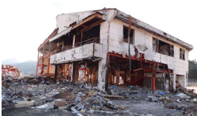
写真14 漁民センターの状況（南西から） （2011年5月2日撮影）
