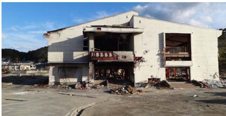
写真15 漁民センターの状況（北から） （画面左側の外壁に焼毀痕。右側（海側）は火災の影響なし。）
